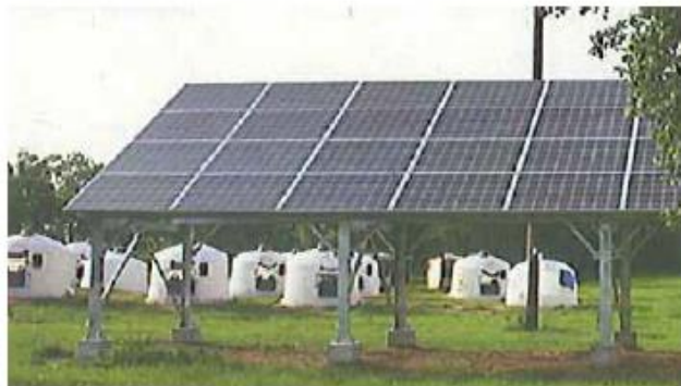
牧場に設置された太陽光パネル
