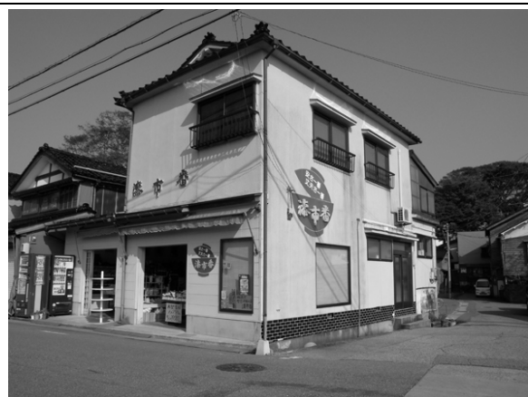
外壁塗装前(側面)
